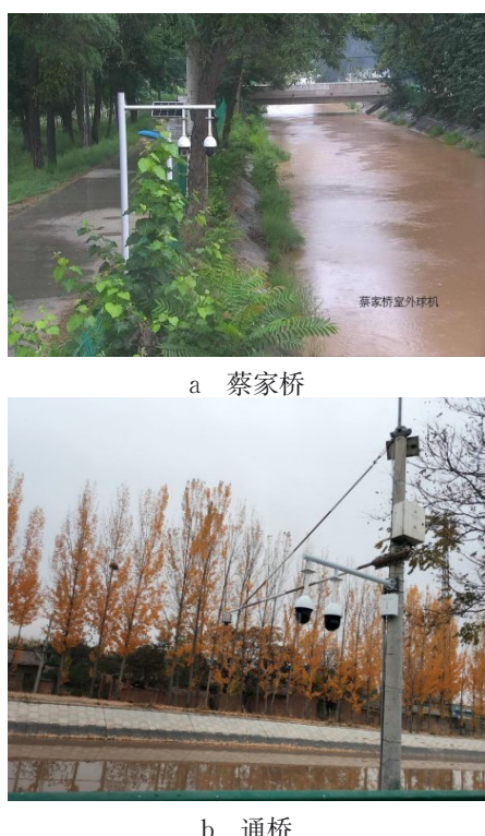
图 3 汉延渠测流系统安装效果
